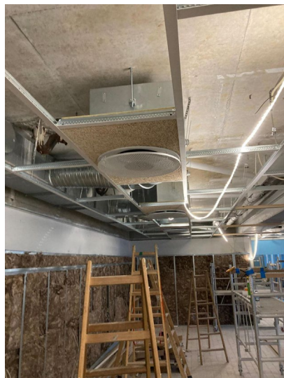
Få tilføjelser var nødvendige til de eksisterende ventilationskanaler: Her et nyt ind-/udblæsningsarmatur
