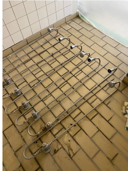
Desværre måtte der alligevel indkøbes nye brusearmaturer
