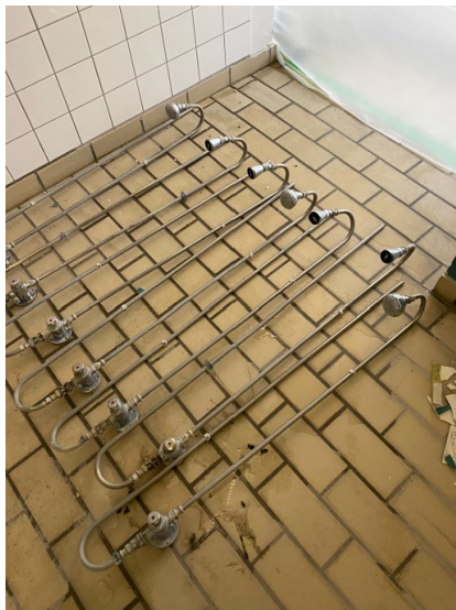
Desværre måtte der alligevel indkøbes nye brusearmaturer
